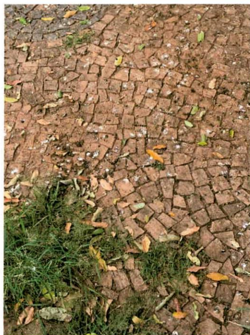
Figura 2 – Detritos acumulados de aves
