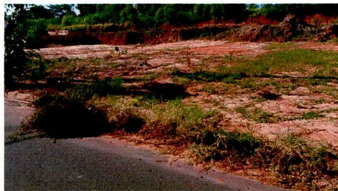
Figura 4 – Material orgânico obstruindo as canaletas.
