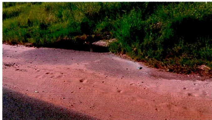
Figura 2 – Terra bloqueando o acesso da boca de lobo.
