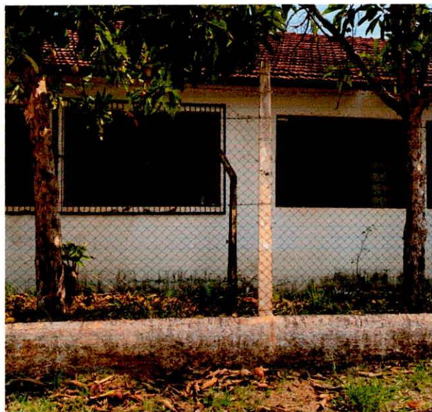
Fig.5 – Vidraças quebradas na Unidade Básica de Saúde.
