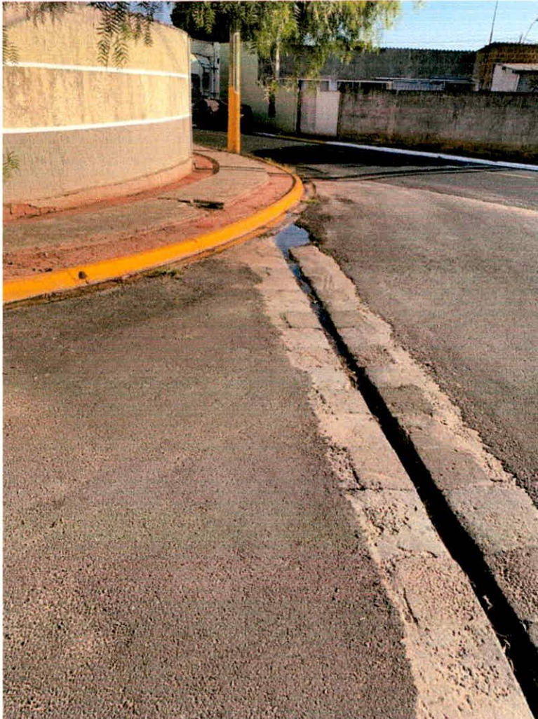
Figura 1 - Local supracitado onde é possível observar o acúmulo de água.
