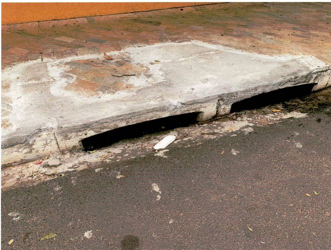
Figura 1 - Boca de Lobo citada na indicação. É possível notar a recente operação do SAAE com cimento fresco ainda sobre a Boca Lobo. Operação foi feita para retirar chave de veículo que caiu dentro da Boca de Lobo.
