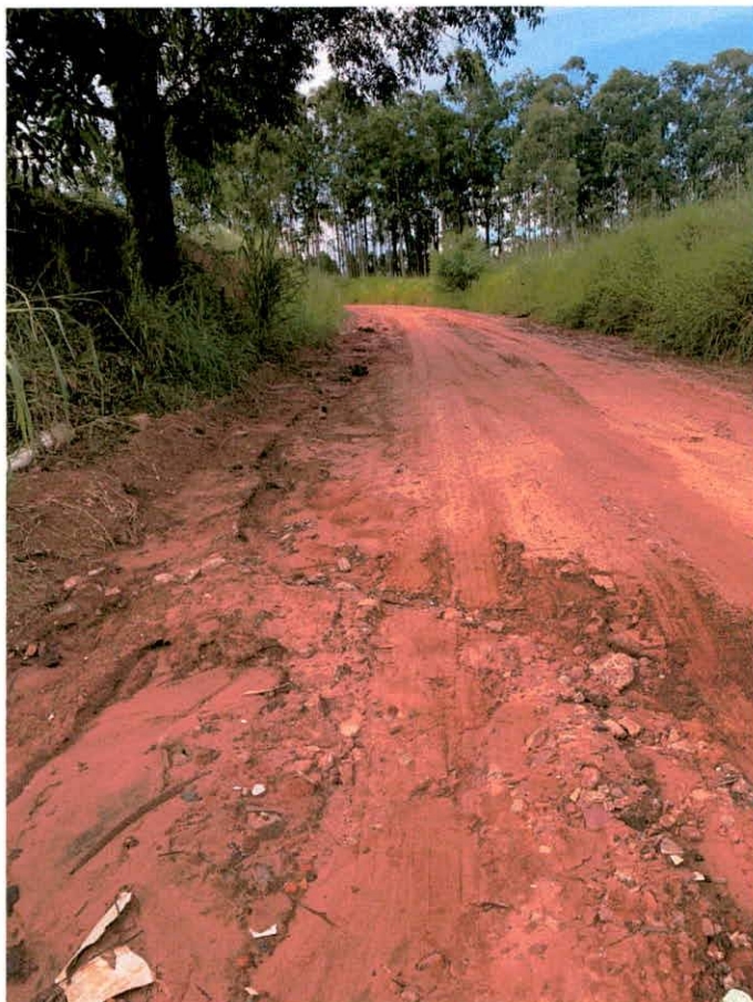
Figura 1. Problema recorrente no trecho da Estrada PMP-338 "Pedro Cassiano". Nota-se que a água da chuva corta a estrada, causando erosão e dificultando a passagem de veículos.
