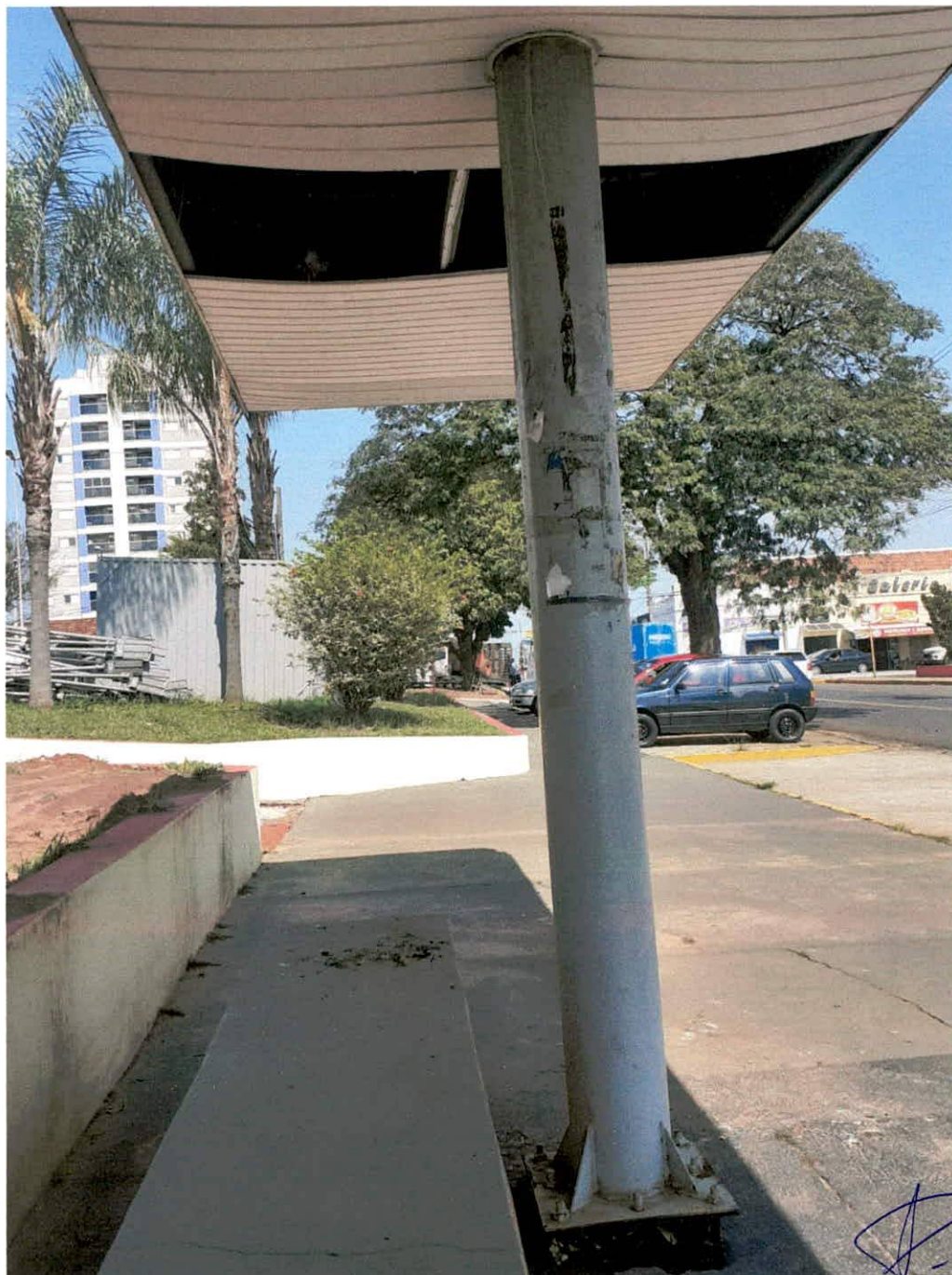
Figura 1 - Ponto de ônibus supracitado com necessidades visíveis de reparos.
